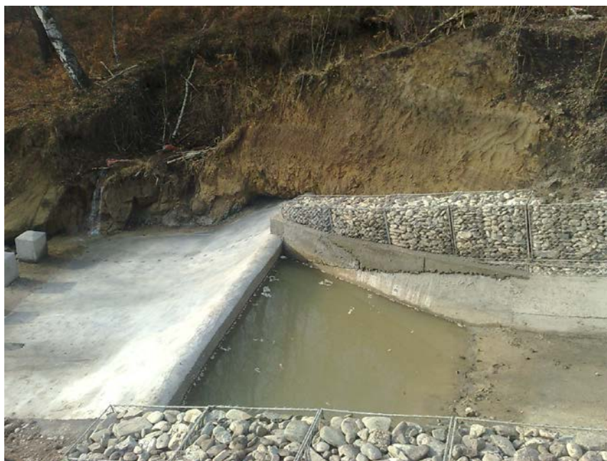
Fig. 3. Deversorul prevazut la capatul din aval al canalului de dirijare pentru reducerea energiei/vitezei apei
